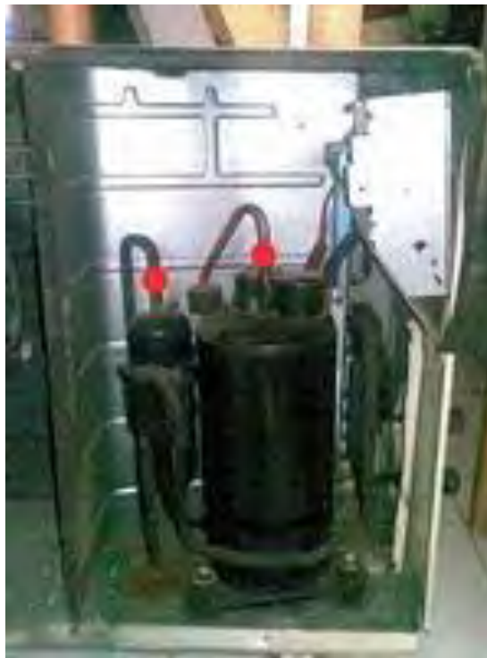
Gambar 4. 24 Kompresor AC Split
