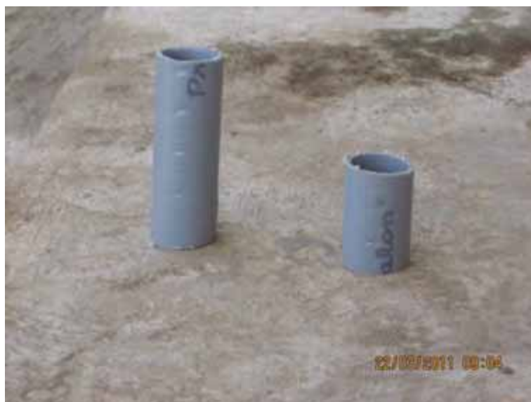
Gambar 167. Bagian dari pipa yang bocor
