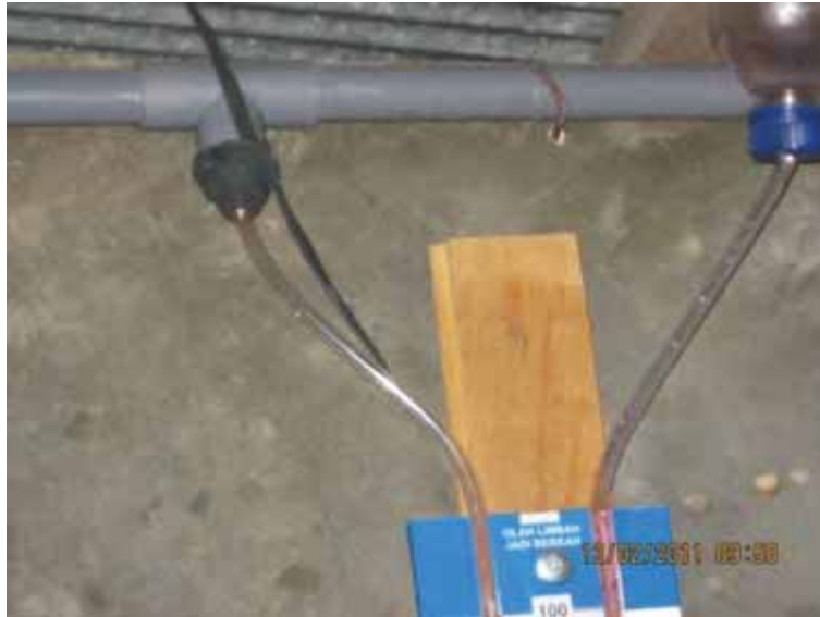
Gambar 168. Mengatasi kebocoran pada nipple untuk sementara
