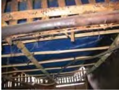
Gambar 38. Kantung biogas di plafon rumah
