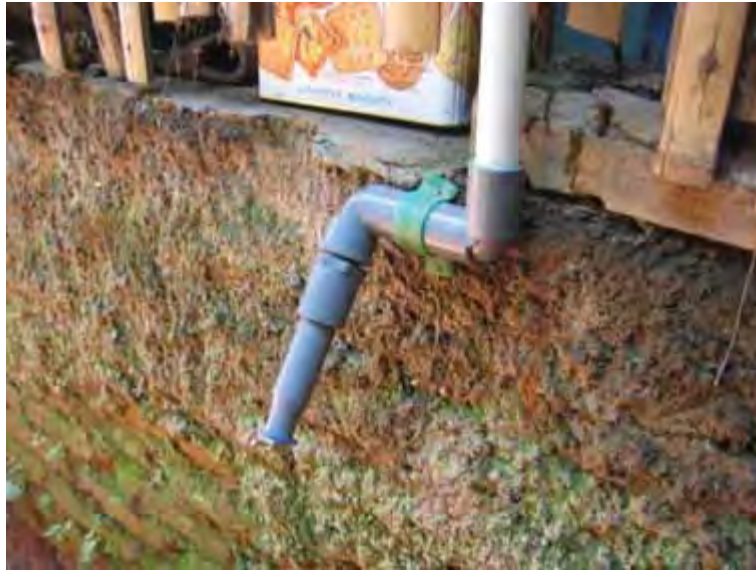
Gambar 148. Pemasangan water drain tanpa kotak
