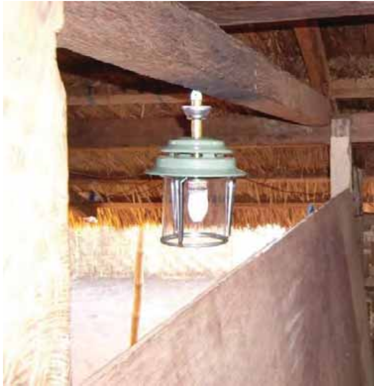
Gambar 171. Contoh lampu biogas di Sumba Barat Daya
