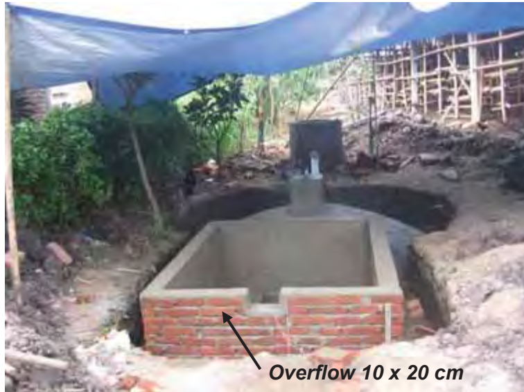
Gambar 120. Overflow pada outlet
