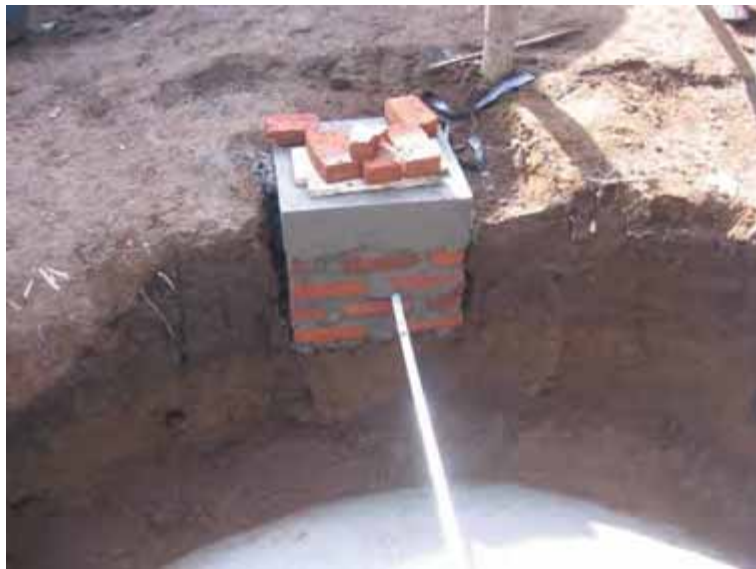
Gambar 147. Kotak water drain yang dipasang dekat reaktor biogas
